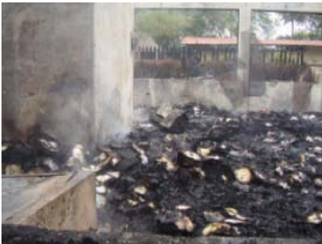
Anexo 2. Fotos do prédio da agência ambiental peruana (INRENA) incendiado na cidade de Pucallpa.
